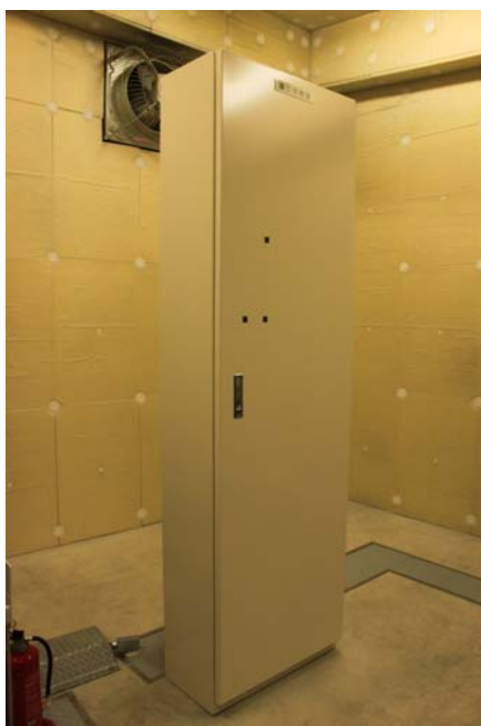
図 4.2 道の駅三本木（宮城県）の自動切替装置
